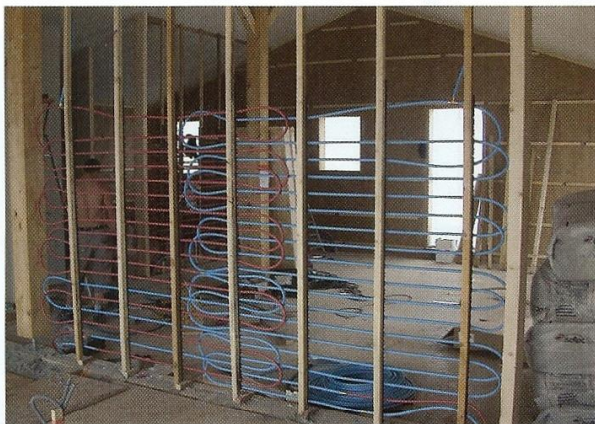
Détail du système de tuyauterie assurant le chauffage des murs.
