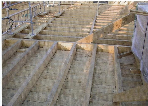
Pour une meilleure isolation et un meilleur confort au niveau du sol, le solivage bois a été préféré à la dalle en béton classique.
