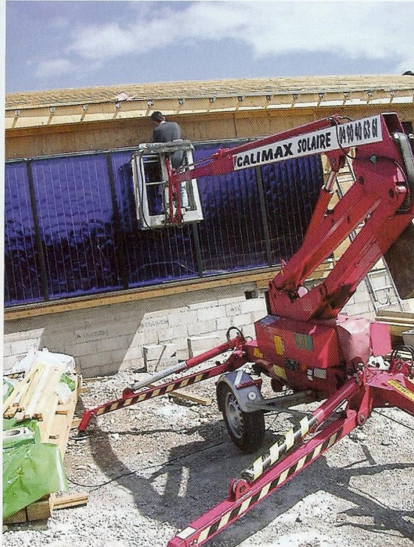
12 m 2 de capteurs solaires, soit 10% de la surface habitable sont installés en façade
