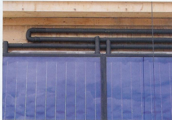
Les capteurs solaires alimentent l'habitation en eau chaude sanitaire mais également un réseau de tuyaux placés dans les murs.
