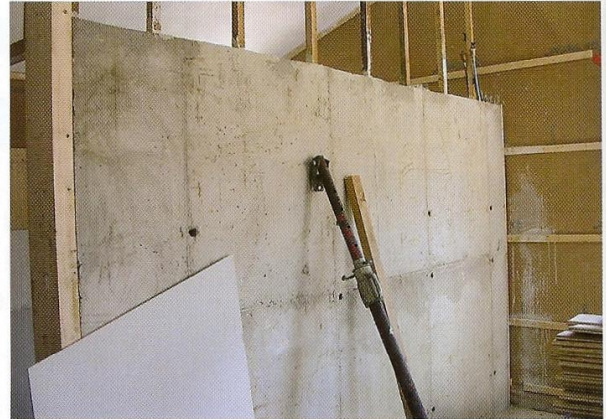
Des murs cloisons en béton de chaux de 10 tonnes permettent de réguler les pics de température. Ils assurent l'inertie que le principe constructif (bois et ouate) n'est pas en mesure d'apporter.
